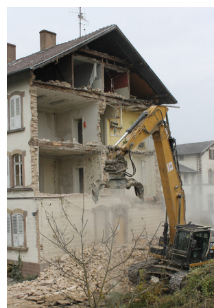
Campus de la Meinau Démolition des anciens bâtiments en vue de la construction de la 2 ème tranche (septembre à novembre 2021)
